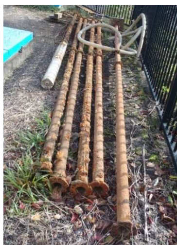
写真 3-2 井戸水中ポンプ 揚水管外壁スケール
