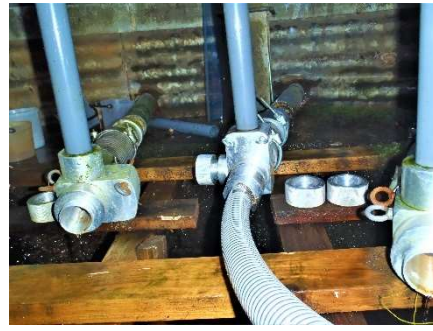
写真 5-8 MNB 水注入時の隣接集水管漏水状況 (左から③~⑤)
