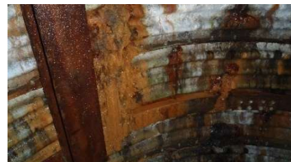
写真 1-2 ライナープレート水抜き穴近傍の水酸化鉄スケール
