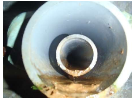
写真 1-1 集水井 T の集水管吐口で視認されたスライム
