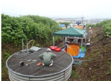
写真 5-3 ④への MNB 水供給状況
