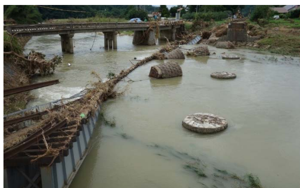
図 1.1.2 2013年7月28日未明から発生した豪雨による山口・島根の流木被害 (山口県阿武川阿東徳佐鍋倉付近)
