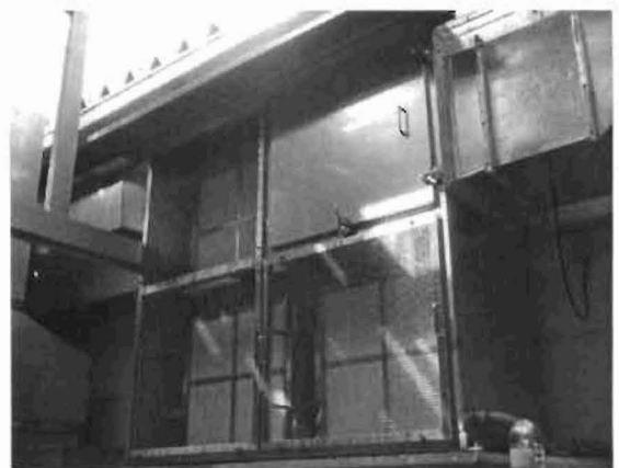
写真1. 光触媒脱臭除菌装置の室外設置例
